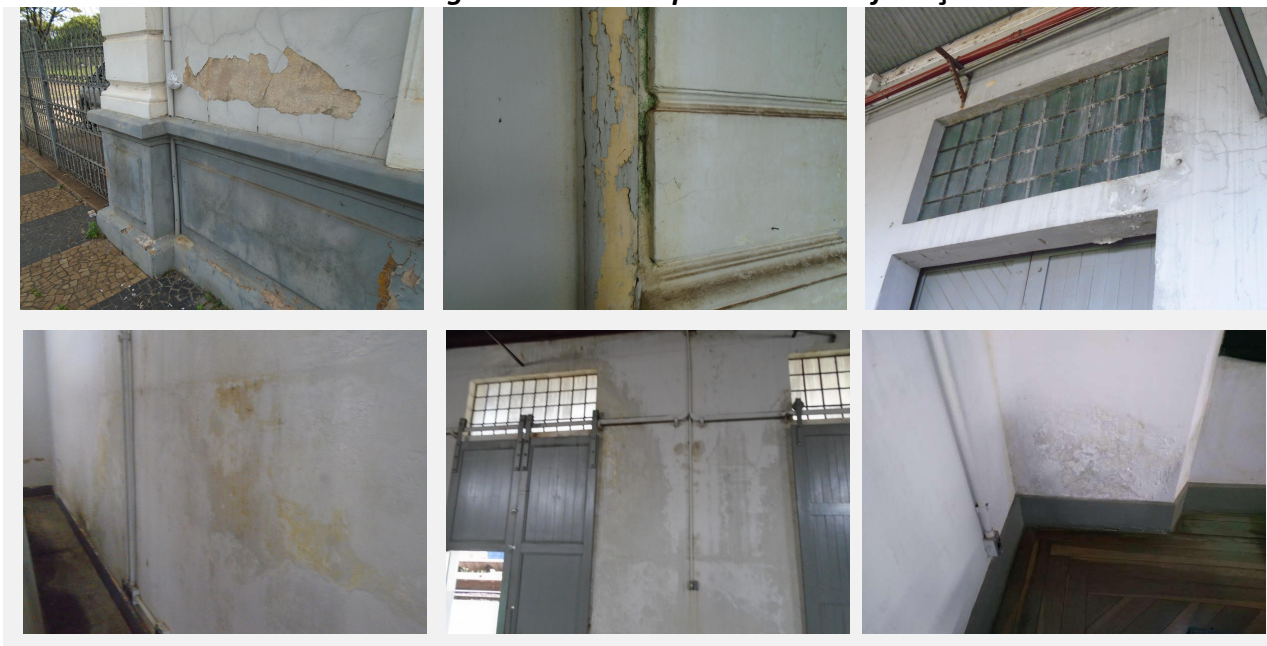
Fig. 3: Pontos com problema de infiltração
