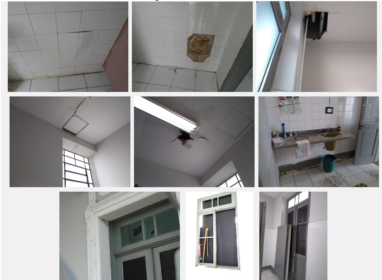
Fig 6: Problemas nos Banheiros
