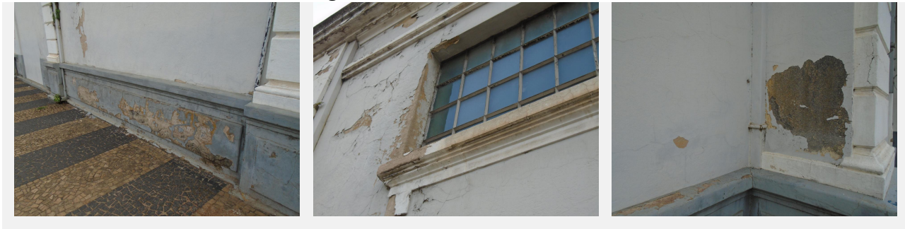
Fig. 5: Pontos com Pintura Descascando
