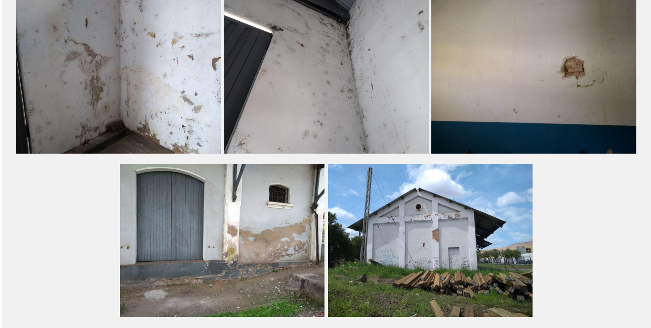
Fig. 10: Problemas de revestimento
