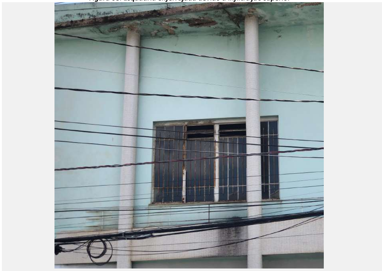
Figura 08: Esquadria enferrujada devido à infiltração superior
