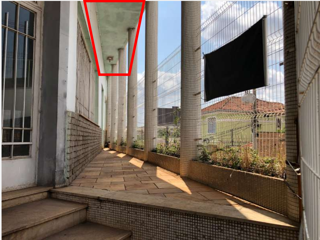
Figura 05: Mosaico Infiltrações nas varandas; lajes do pav superior
