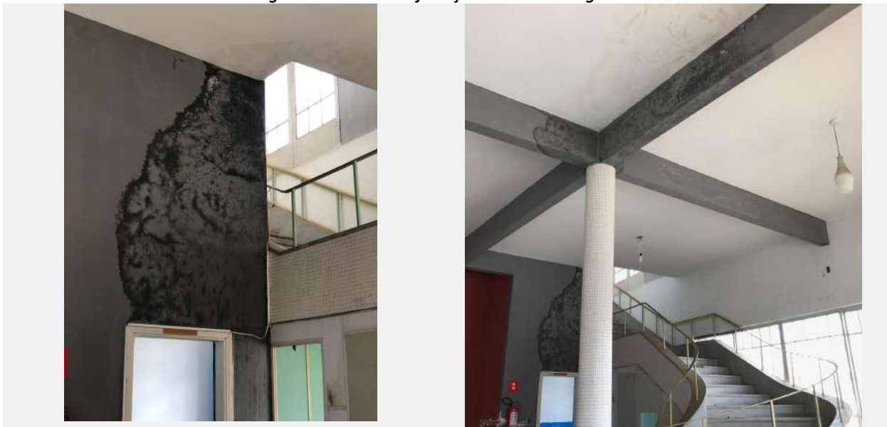
Figura 13: Mosaico infiltração e danos no saguão
