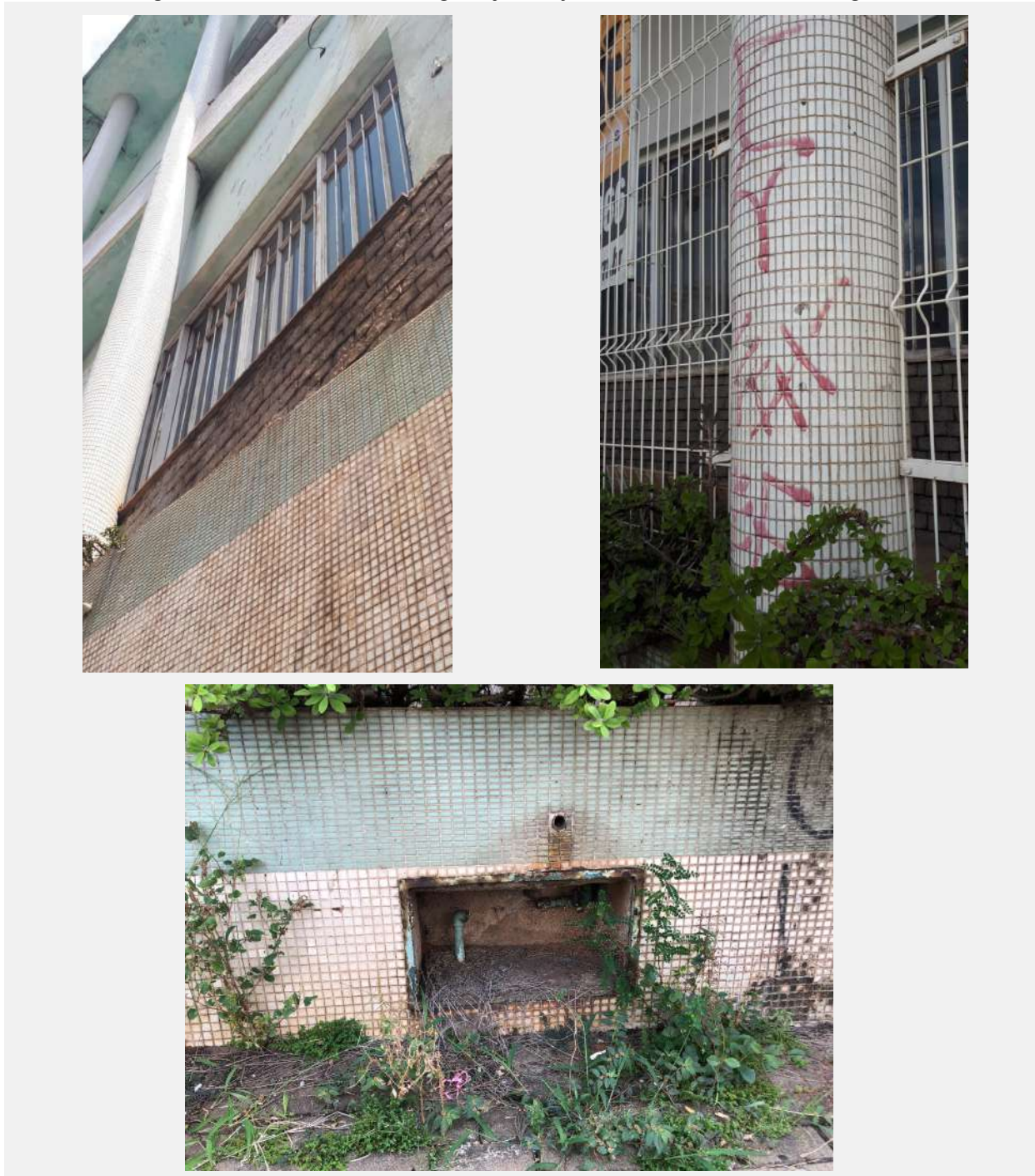
Figura 07: Mosaico Detalhes de degradação das fachadas e caixa de entrada de água
