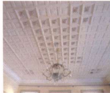
Foto 17 – Detalhe do madeiramento do Forro.
